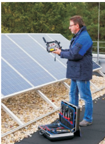
Durch regelmäßiges Prüfen können Fehlerquellen in Anlagen früh erkannt werden. Foto: TÜV Rheinland
